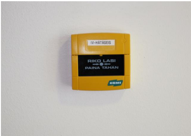
Bild 3 (Avbrytaren för snabbstängning av luftkonditioneringen)
